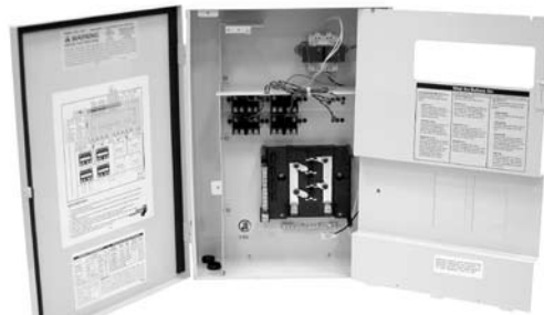
Panel del centro de de carga secundario. (con soportes y placa de montaje para interruptor de circuito)
